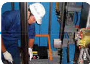
Bảo trì – bảo dưỡng vệ sinh cabin
